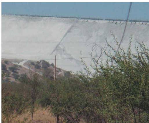
Figura 7. Tranque Las Tórtolas de Minera AngloAmerican después de la ocurrencia del megasismo de Concepción en febrero de 2010 (fotografía tomada el 27 de marzo de 2010). (a) Aspecto del muro de contención donde se observa la fractura y el hundimiento parcial (aproximadamente un metro) de su porción occidental. (b) ampliación de la porción superior del muro con hundimiento de su porción occidental. Reproducido de Tchernitchin et al., Cuad Méd Soc (Chile) 52: 199-214, 2012
